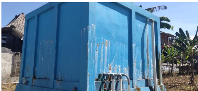
Gambar 3. Bak Penampungan Air
