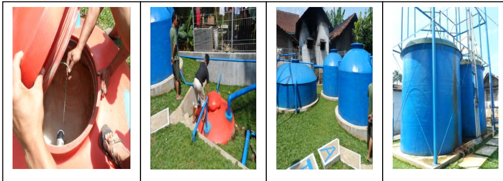
Gambar 2. Instalasi Pengolah Limbah Tahu Cair
